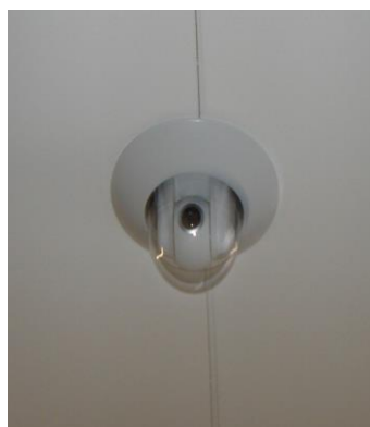
Figura 5. Detalle de una de las cámaras PTZ situada en el techo del vestíbulo de la Escuela.
