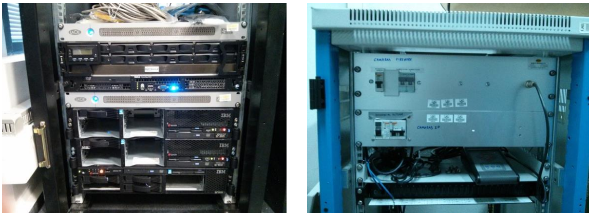
Figura 13. Detalle de equipos de proceso (izda.) y del punto de acceso y control de parte de las cámaras (dcha.).
